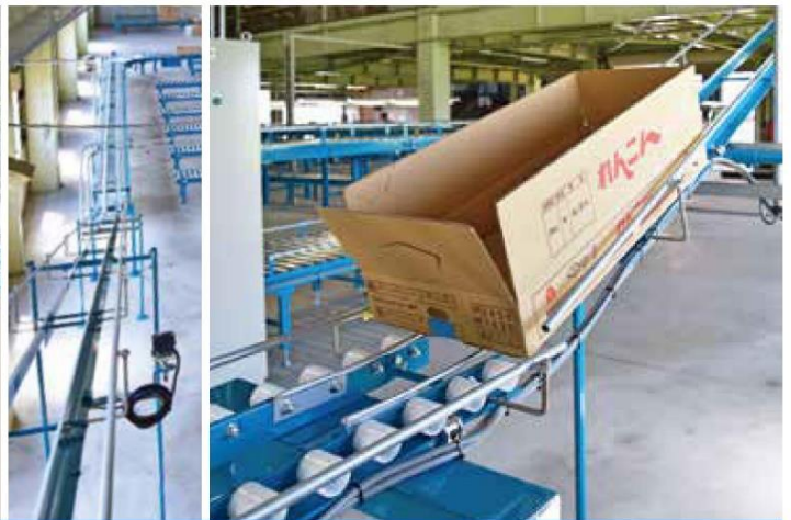
4 製函空箱搬送設備 製函機で組み立てられた出荷段ボールを荷造り部へ搬送。
